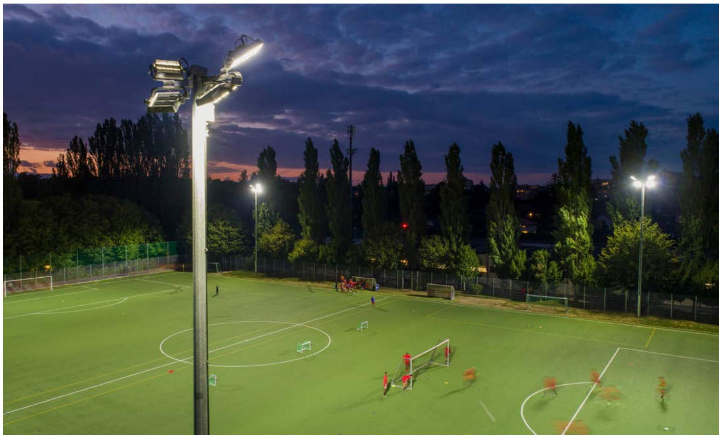
Auch im Stade des Trois-Chêne in Chêne-Bourg GE wurde die Flutlichtanlage auf Basis der LED-Technik optimiert.
