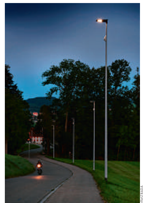
LED-Sensorleuchten haben eine «Schwarmintelligenz», welche für «mitlaufendes» Licht sorgt
